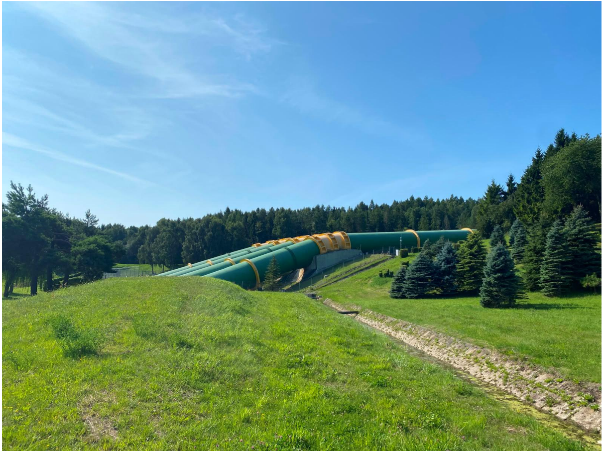
Maan alla sijaitsevaan voimalaan johtavat paineputket.
